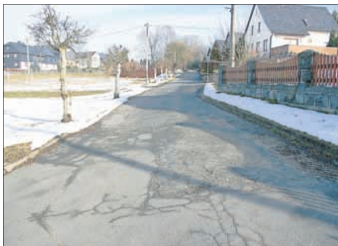
Straßenschäden im Ortsteil Oberlemnitz
