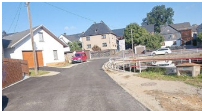
In Helmsgrün wurde die Querstraße an der Feuerwehr asphaltiert. Vorher hatte die Straße einen ungebundenen Oberbau, der regelmäßig nach dem Winter vom Bauhof ausgebessert werden musste.
