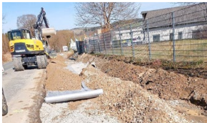
Neubau des Gehwegs in der Unterlemnitzer Straße mit Verrohrung der Straßenentwässerung mit Fördermitteln des Landes Thüringen im Förderprogramm „KVI – Kommunale Infrastruktur“ (hier ist jetzt unter anderem die Werkstatt für behinderte Menschen im Gewerbegebiet „Unterlemnitz“ sicher zu Fuß zu erreichen).
